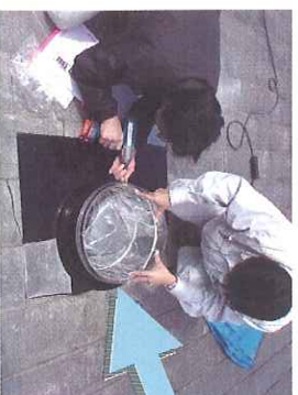
屋根上のクリアドーム
